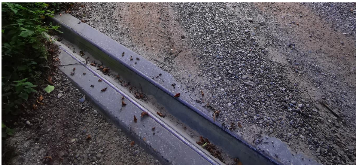
Slika 7: Vbetoniran dražnik v obliki črke V.
