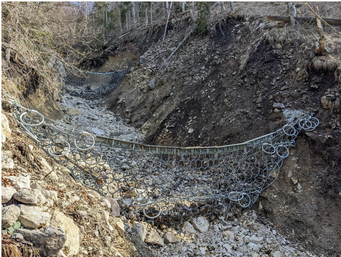
Slika 23: Mrežna hudourniška pregrada v Brezovškovem grabnu pod Krvavcem (Cej T.)
