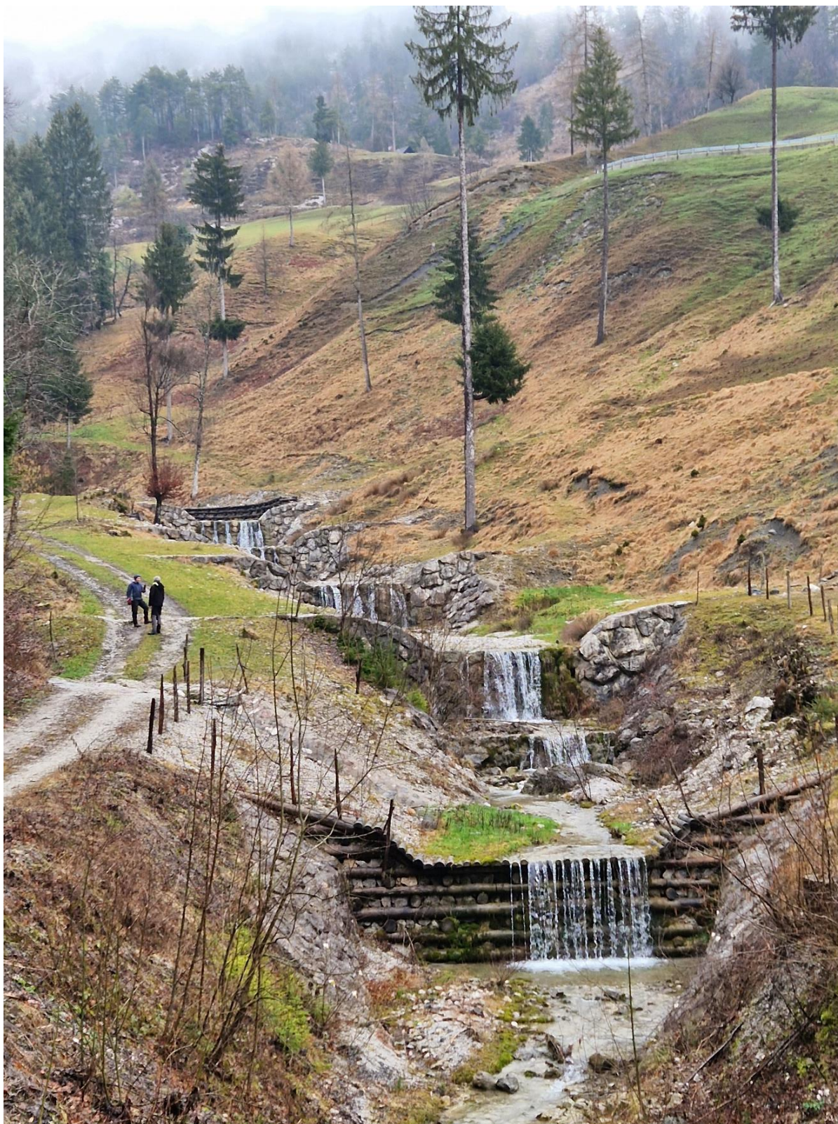
Slika 29: Sistem ustlitenih pregrad iz kamna v betonu in lesene kaše na Bistričici (Vilhar U.)
