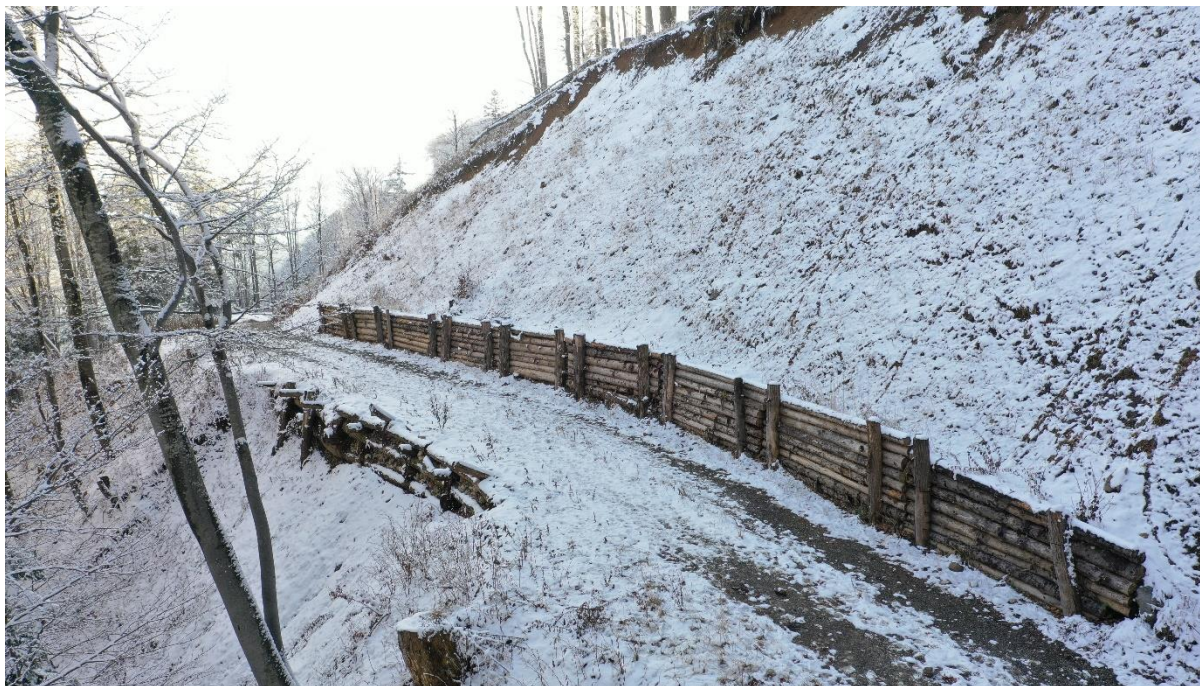
Slika 10: Zložba iz oblic nudi zaščito pred posipanjem odkopne brežine, medtem ko lesena kašta tudi oporo vozni konstrukciji, na območju Železnikov (Saražin J.)
