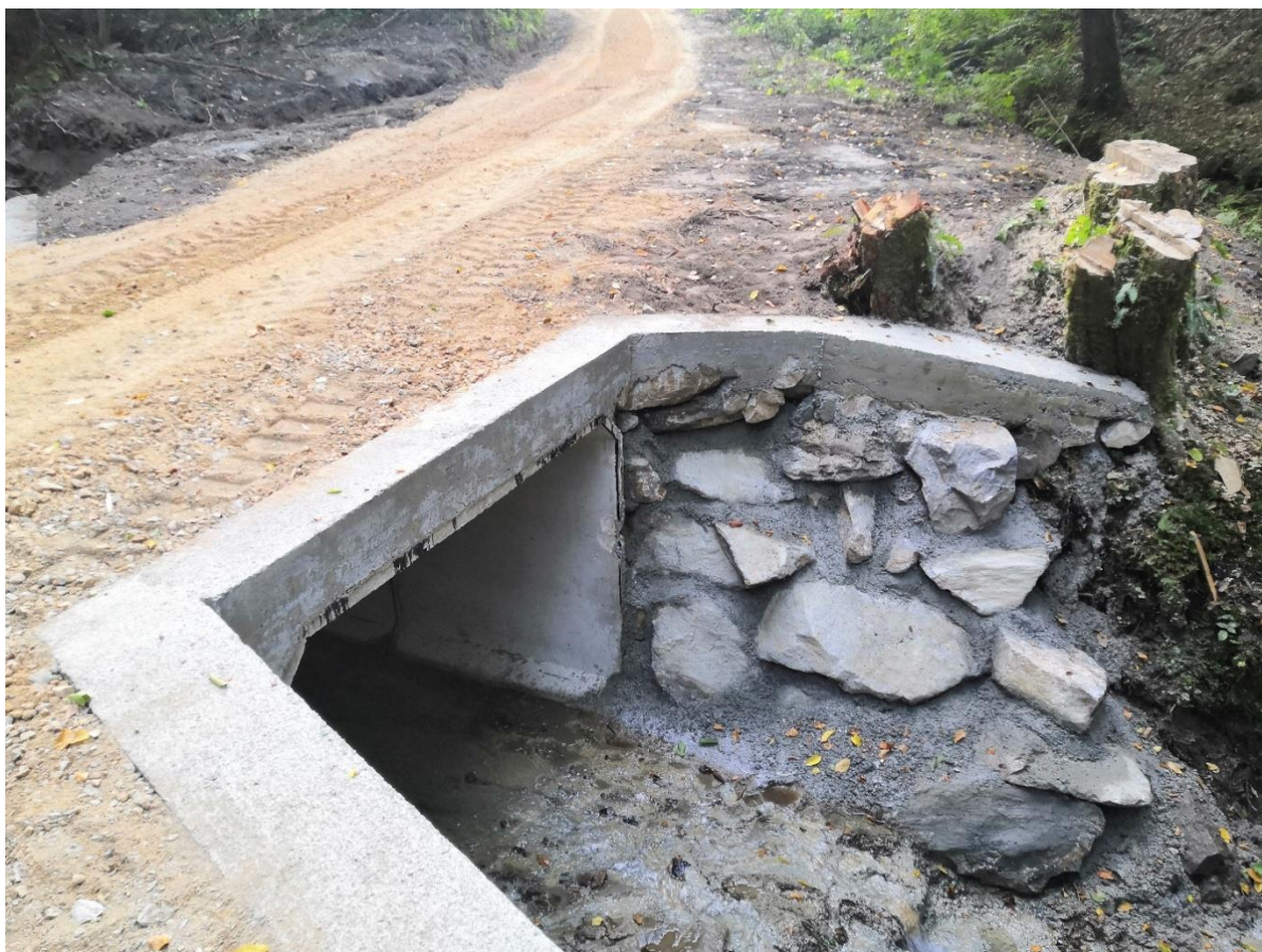
Slika 46: Škatlasti prepust na gozdni cesti z urejenim vtokom (Benčina A.)
