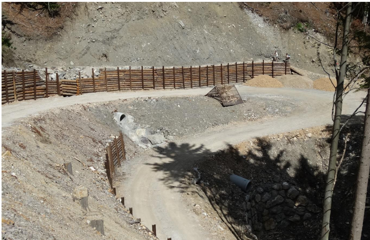
Slika 11: Lesene oblice so zložene za kovinske pilote na gozdni cesti na Jezerskem (Saražin J.)
