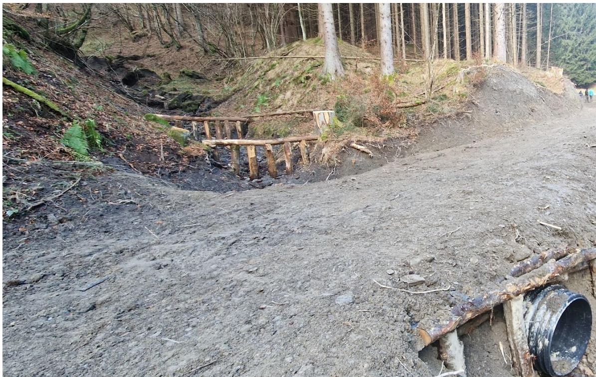
Slika 36: Sistem manjših prebiralnih grabelj pred cevnim prepustom (Vilhar U.)
