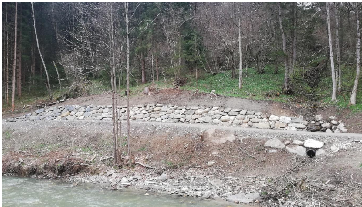
Slika 12: Zložba v suho na odkopni brežini gozdne ceste v okolici Beljaka (Saražin J.)
