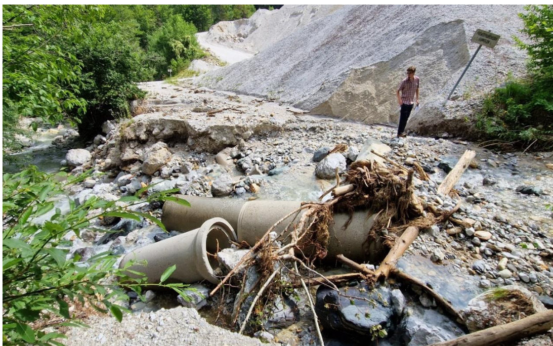
Slika 2: Krajši odsek gozdne ceste, ki jo je odnesel hudournik zaradi zamašitve dvojnega cevne propusta (U. Vilhar).
