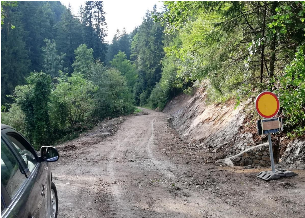
Slika 9: Gozdna cesta nad Topolščico je bila delno sanirana že v prvih dneh po ujmi (J. Saražin)
