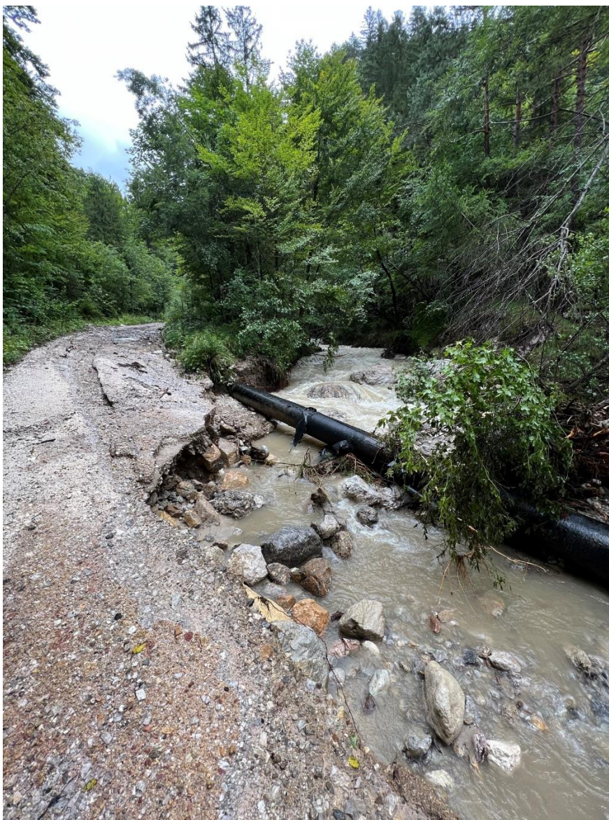
Slika 4: Uničena cestna infrastruktura in poškodovan vodovod v dolini Završnice zaradi naraslih hudournikov. Podobnih primerov je na tem območju veliko na različnih odsekih doline (foto: A. Marinšek)
