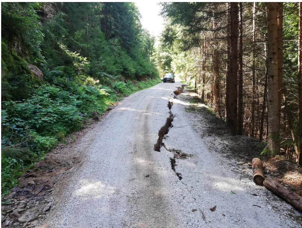
Slika 14: Brez ustrezne sanacije ta gozdna cesta še dolgo ne bo prevozna za tovorna vozila (J. Saražin).
