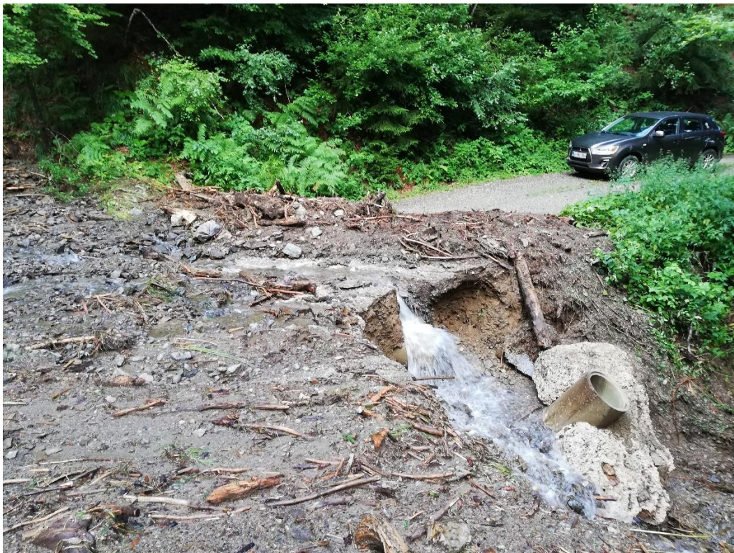
Slika 10: Sosednja gozdna cesta pa je še čakala na sanacijo. Nezadostno utrjeni iztoki in okolica cevnih prepustov so pogosto rezultirali v poškodovanju ali izpadu zadnjega cevnega prepusta (J. Saražin).
